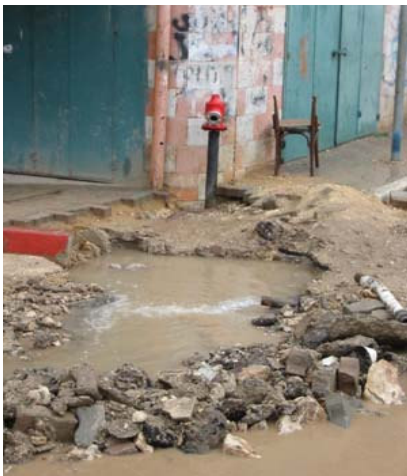
Beschädigtes Leitungsrohr nach israelischer Invasion, Jenin 2002
